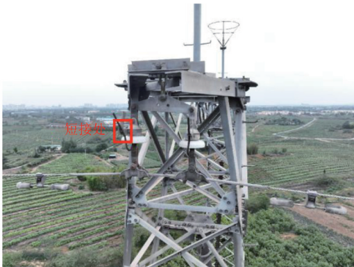
图 2 103 号铁塔左侧地线飞巡照片
