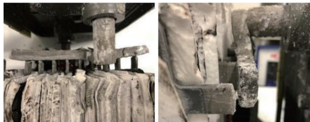
(a) 23号蓄电池
