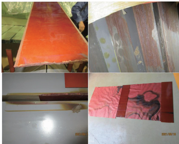
图 5 铁芯解体后多处碳化发黑
