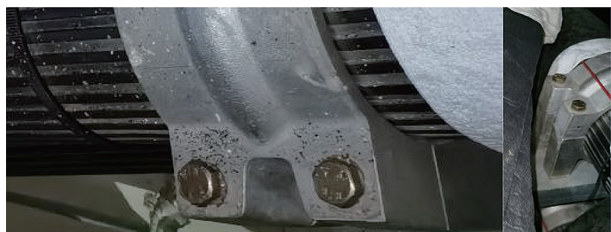
图 14 某水电厂 500 kV 电缆金属夹具安装情况
