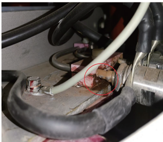
图4 水管与压板振动磨损缺陷
