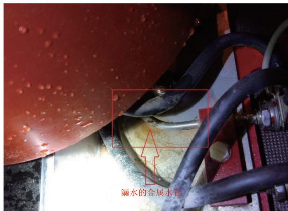
图3 电缆和水管接触磨损缺陷
