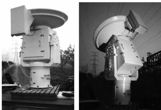
图 6 雷达监测装置现场安装运行
