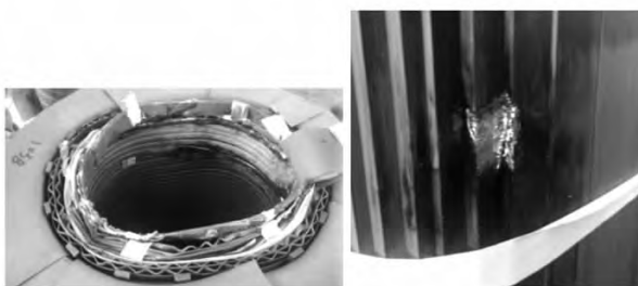
(a) 低压首端绕组绝缘碳化 (b) 铁芯表面烧蚀
