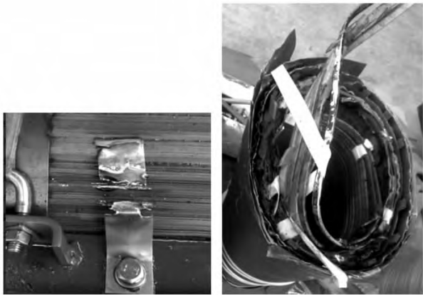
(a) 铁芯接地铜排烧断 (b) 低压绕组引线绝缘碳化
