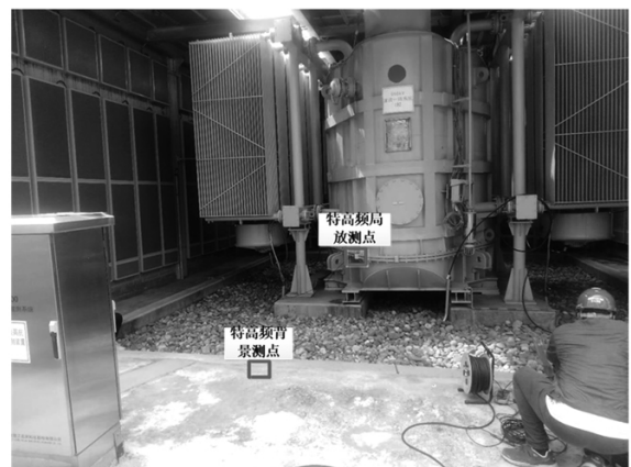
图1 变压器类设备特高频检测传感器布置 值大小和信号到达时间判断信号是否来自设备内部。以图1所示500 kV某线路C相高压电抗器现场实测信号(见图2)为例,图2中1通道为壳体法兰接缝处特高频检波信号;2通道为背景噪声特高频检波信号,可见,仅壳体法兰接缝处存在100 Hz
