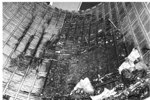
(a) 高压火线出头往右第1-8档内侧导线绝缘碳化情况
