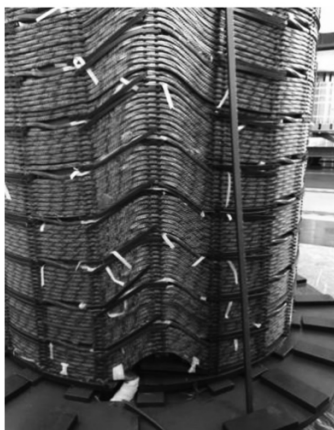
(d) B相绕组外侧形变情况
