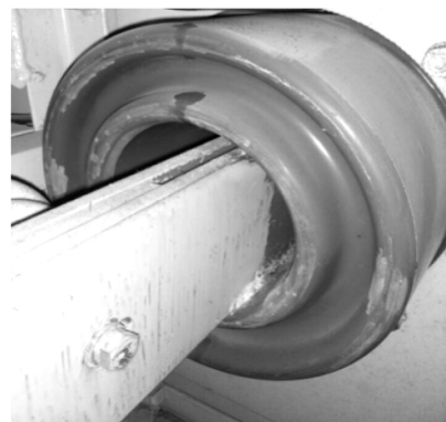
图8 902开关柜穿柜套管A相
