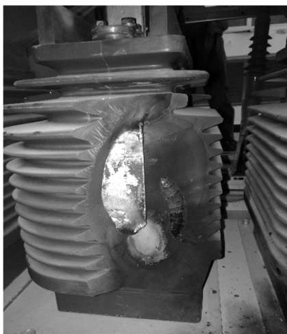
图2 1号主变压器 35 kV 侧 B相 CT 进一步检查结果如下:
