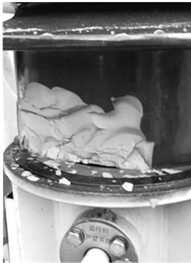
图4 九寨沟变电站 110 kV 1号主变压器 高压侧套管根部受损破裂漏油情况
