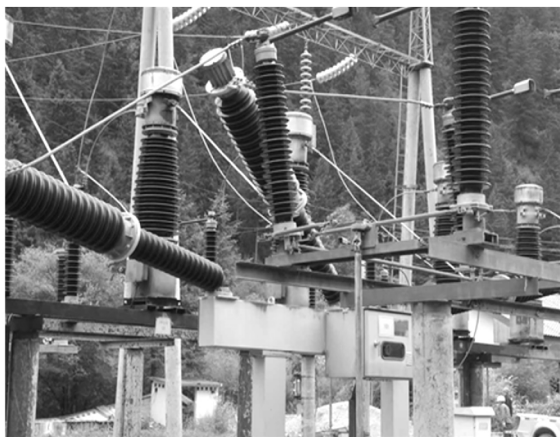
图5 110 kV 九寨沟变电站部分开关根部断裂
