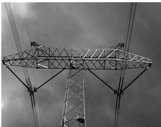
图1 ±400 kV 柴拉直流线路直线塔 安装绝缘护套后效果图
