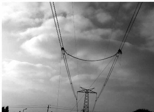
图3 极间间隔棒在高耸直流的挂网情况
