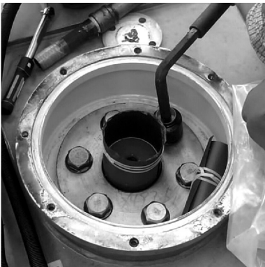
图 2 变压器夹件定位销实际情况图
