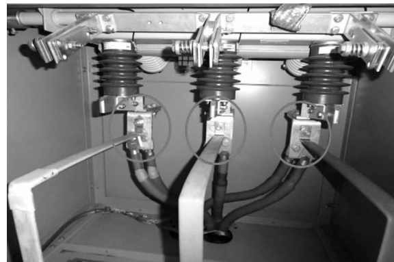
图 8 10 kV 电容器刀闸下端头与直流融冰装置电缆连接点
