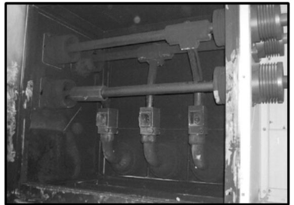
图1 35 kV II段母线TV柜所在母线室
