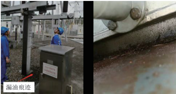
图 7 某 110 线路 CT 渗油缺陷
