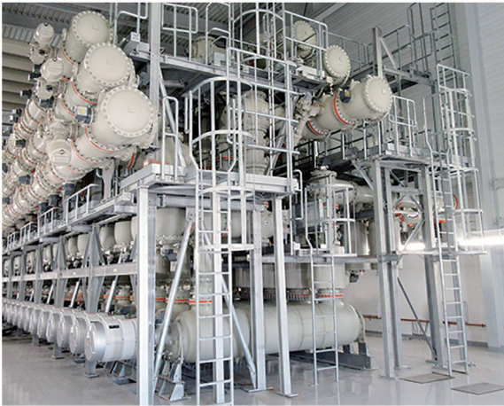
图 2 ABB 公司的环保型 380 kV GIS 安装在德国 TransnetBW 公司的 Weier 变电站
