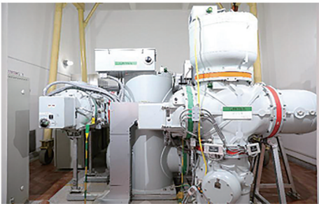
图 7 安装完成的 110 kV C4 环保气体 GIS 完整间隔
