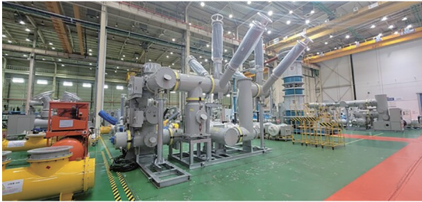
图 4 韩国首个环保型 170 kV GIS
