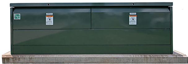
图 5 Vista 绿色地下配电开关柜
