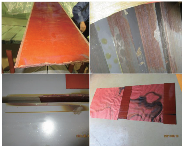
图 5 铁芯解体后多处碳化发黑
