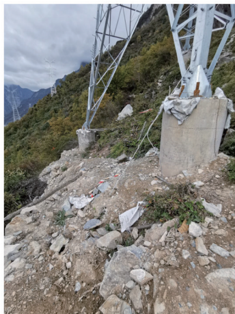
图2 施工弃土堆载诱发滑坡
