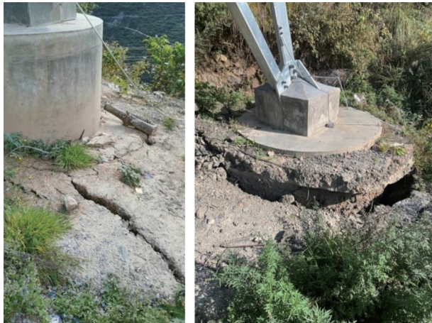
图 5 基础周围土体裂缝和脱离
