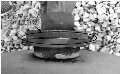
图 1 高压 A 相套管密封部位有缝隙
