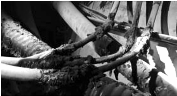
图 2 电缆烧损故障火源起点
