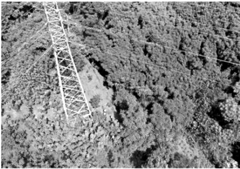
图 4 110 kV 某线路区域发生山体滑坡
