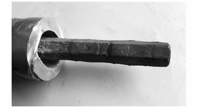
图 5 钢锚外观形貌
