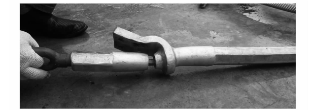
图 2 耐张线夹铝管断裂位置
