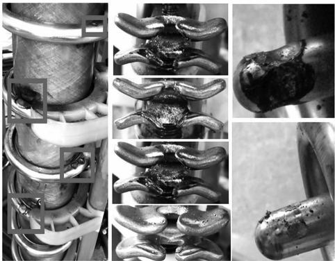
图3 分接选择器部分烧损情况
