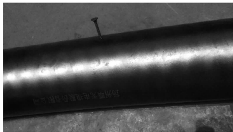
图 3 高压电缆外破缺陷
