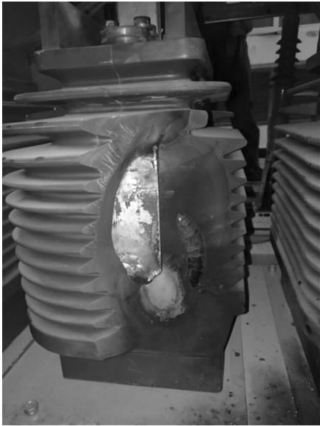
图 6 303 断路器 B 相 CT 炸裂现场
