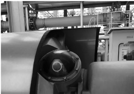
图1 组合电器断路器 C 相机械显示(分闸状态)
