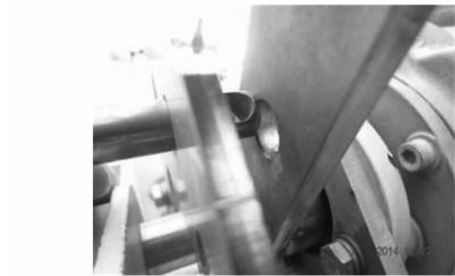
图6 1034 隔离开关分闸对位情况
