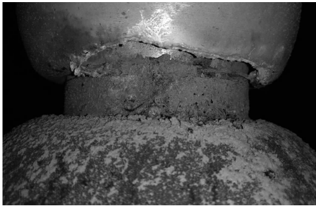
图 5 1 号主变压器 2016 隔离开关气室 A 相放电盆式绝缘子
