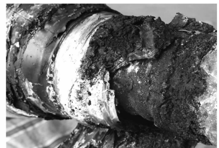
图 3 击穿点附近的电缆焊接情况
