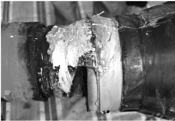
图4 非击穿侧的电缆焊接情况
