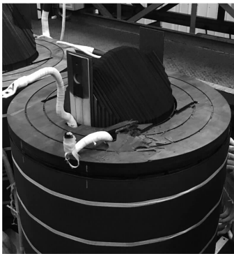
图3 变压器B相绝缘压板破损情况
