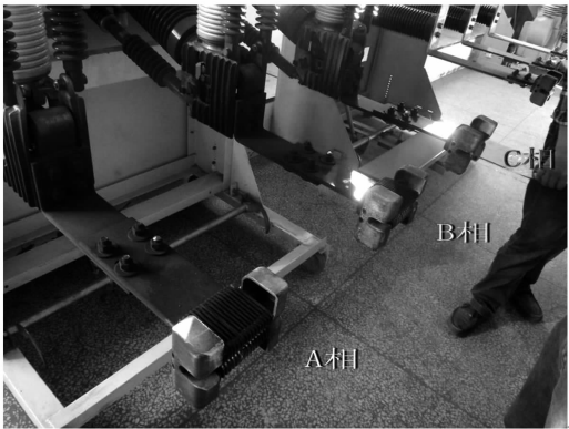
图6 35 kV 分段 313 断路器手车故障情况
