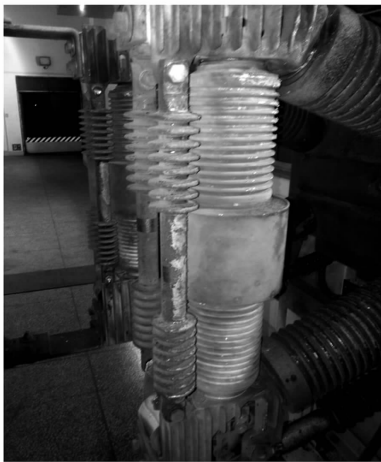
图7 35 kV 分段 313 断路器手车烧蚀情况
