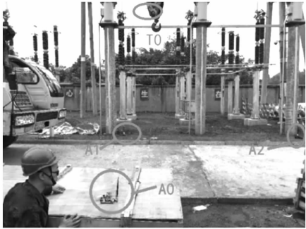
图 6 某 220 kV 变电站现场应用
