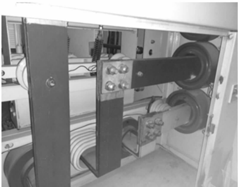
图 7 902 开关柜内存在环氧树脂粉末的穿柜套管
