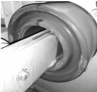
图 8 902 开关柜穿柜套管 A 相
