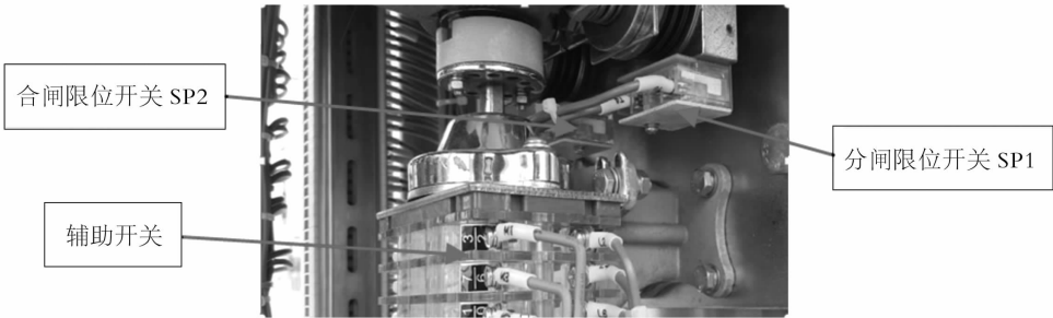
图9 改造前隔离开关操作机构
