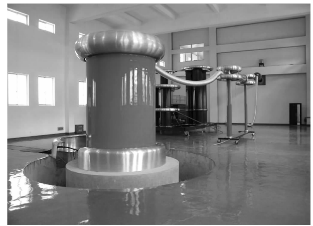
图 2 200 kV 交流污秽试验电源
