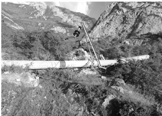
图6 35 kV 南黄线输电线路84号杆塔倒塌情况
