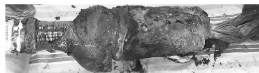
图 1 甲线 3 号电缆接头 B 相烧损严重
