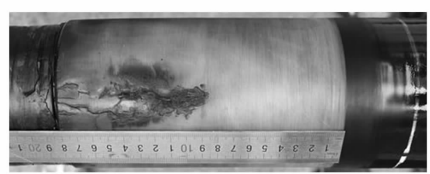
(b) 乙线 5 号电缆接头
