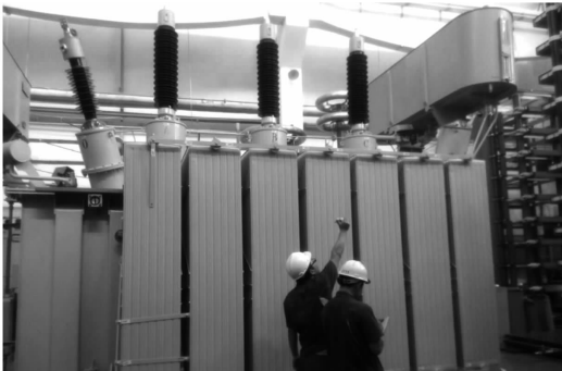
图 8 电力变压器噪声控制与抑制实验系统 在上述 110 kV 大容量油浸式电力变压器噪声
