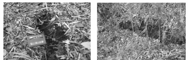
图 6 313 号塔位变形体后缘拉裂缝
