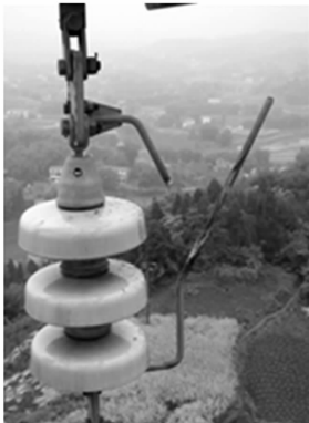
图 1 4 号塔左侧导线大号侧招弧角的电弧烧蚀痕迹
