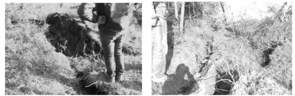
图 5 314 号塔位滑坡体上的拉张裂缝
