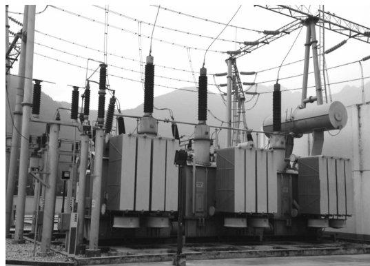
图1 幸福站2号主变压器
