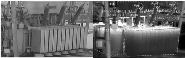
图 5 双视监控器中变压器的现场图像
