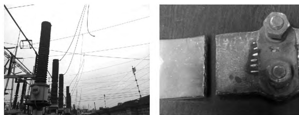
图 1 断裂的 PT 引流线夹
