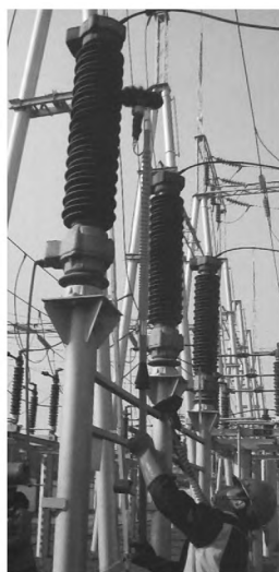
图2 220 kV 变电站试验
