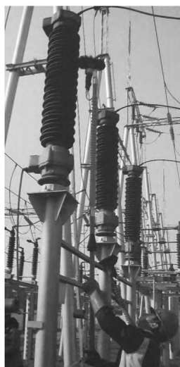
图2 220 kV 变电站试验
