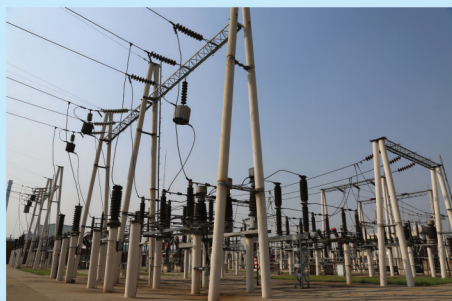
锅盖梁变电站
