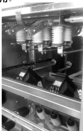
图 3 XGN2-40.5 kV 型高压开关柜试验平台
