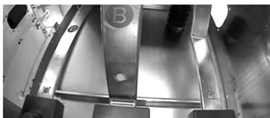
图 2 安装于开关柜内的水平广角摄像头
