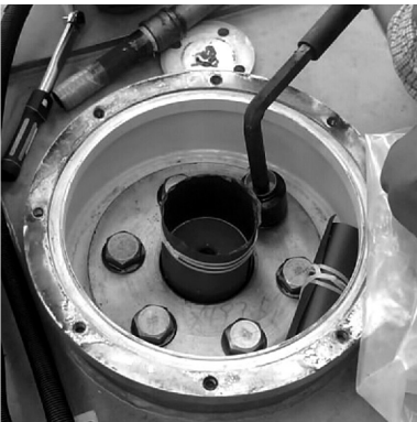
图 2 变压器夹件定位销实际情况图
