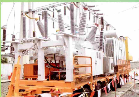
2013年8月28日，国内首座110 kV移动变电站在国网德阳供电公司110 kV光明变电站内接入电网，并成功投运。
