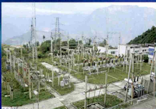
公司110 kV锅盖梁变电站全貌
