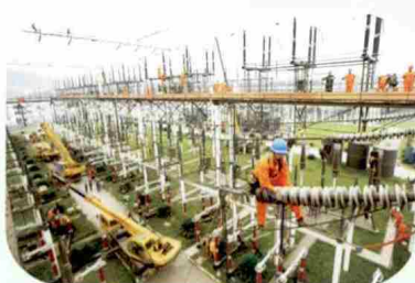
达州500 kV变电站
