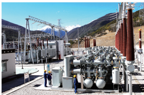
220 kV幸福变电站
