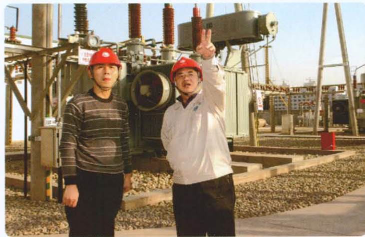
◆ 党委书记骆国富视察110 kV花溪变电站
