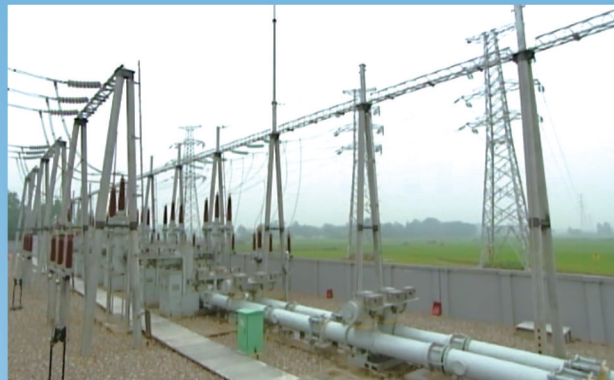
110KV GIS屋外配电装置
