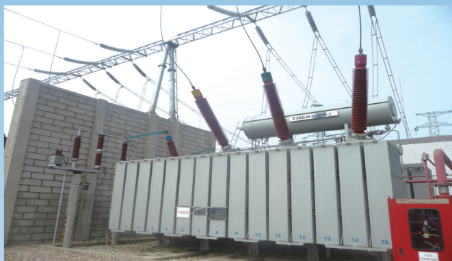
苏场变电站220kV 主变压器及防火墙联合构架
