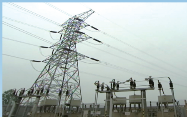
220kV 苏场变电站220线路与10kV 电容器组
