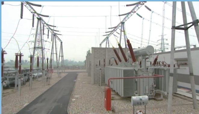
户外GIS变电站
