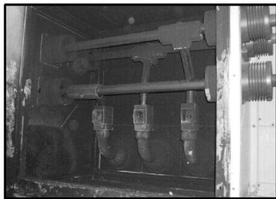
图1 35 kV II段母线TV柜所在母线室
