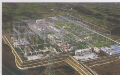
1000kV特高压荆门变电站全景
