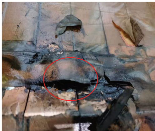
图 13 屏蔽带脱焊放电痕迹
